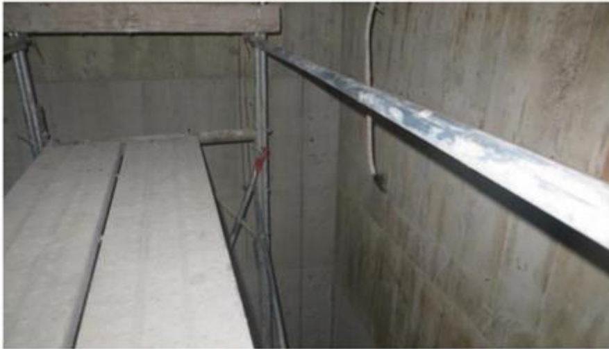
圖 5 現場施工架開口過大
