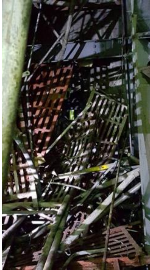
圖 14 倒塌現場之施工架
