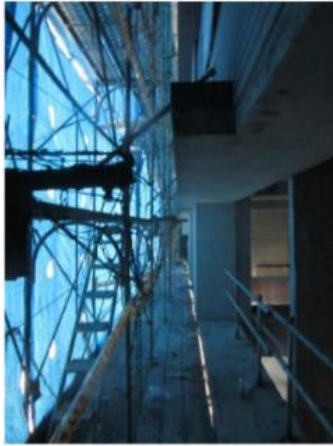
圖 10 施工架開口未設有防墜設施
