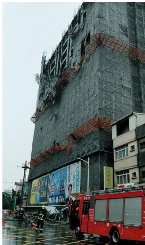
圖 16 施工架倒塌現場
