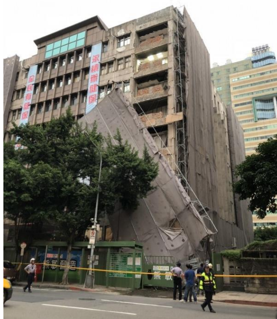
圖 17 外牆施工架倒塌現場
