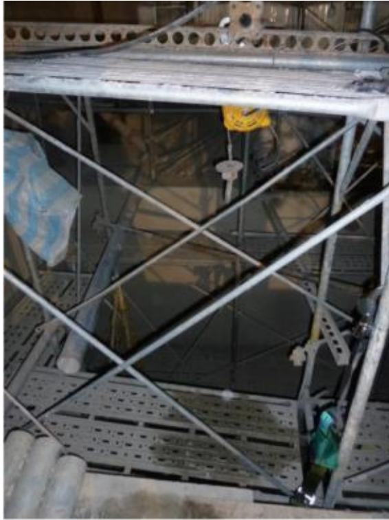
圖 9 施工架開口未設置防護措施
