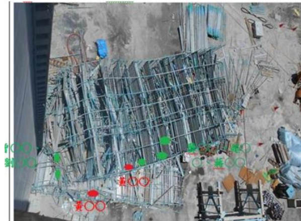
圖 11 職災發生現場
