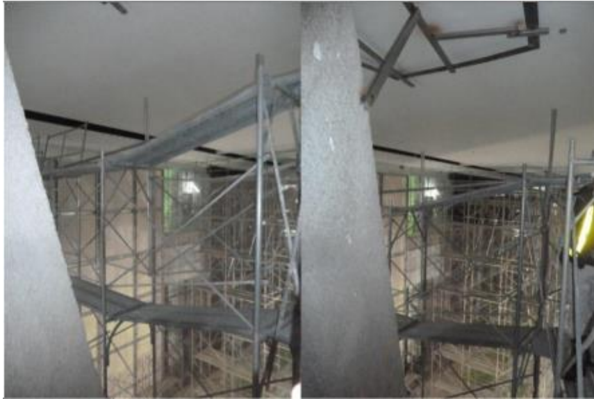
圖 7 施工架最上方未裝設護欄或其他防墜落措施
