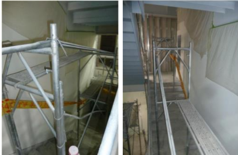
圖 8 開口未設置護欄、交叉拉桿等防護措施，踏板未滿鋪
